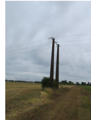
Pylône de la ligne HTA interceptant la zone ouest d'étude
