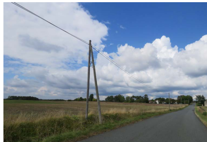
Ligne de télécommunication longeant la RD 22 au niveau du lieu-dit « La Potence »
