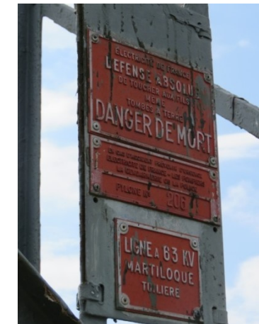
Panneau des caractéristiques de la ligne THT traversant la zone est d'étude
