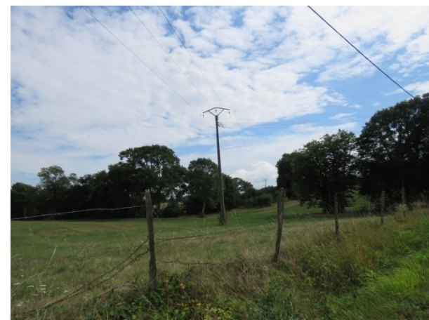
Ligne électrique HTA traversant l'ouest de la zone est d'étude
